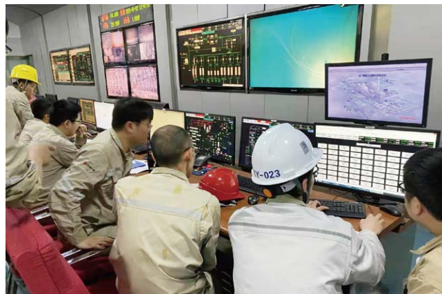
科远智慧工程师与大唐南电技术人员一起调试自主可控NT6000系统
